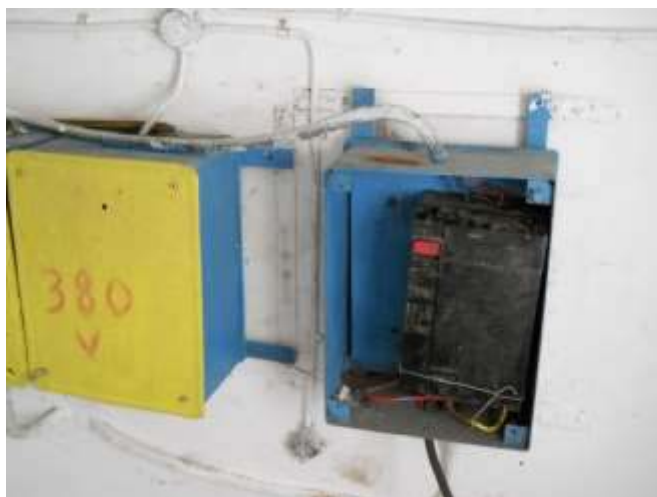
Corabia - Alimentare cu en electrica improprie puturi existente
