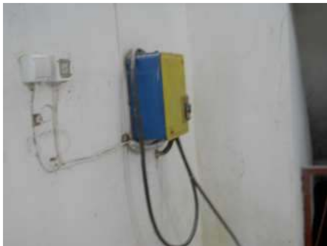
SP Re-pompare Corabia – alimentare cu energie electrica
