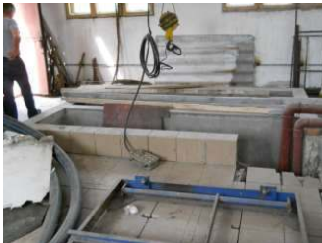
Detaliu Statie tratare – nefunctionala
