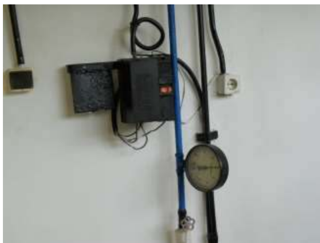
SP Re-pompare – detaliu panou comanda
