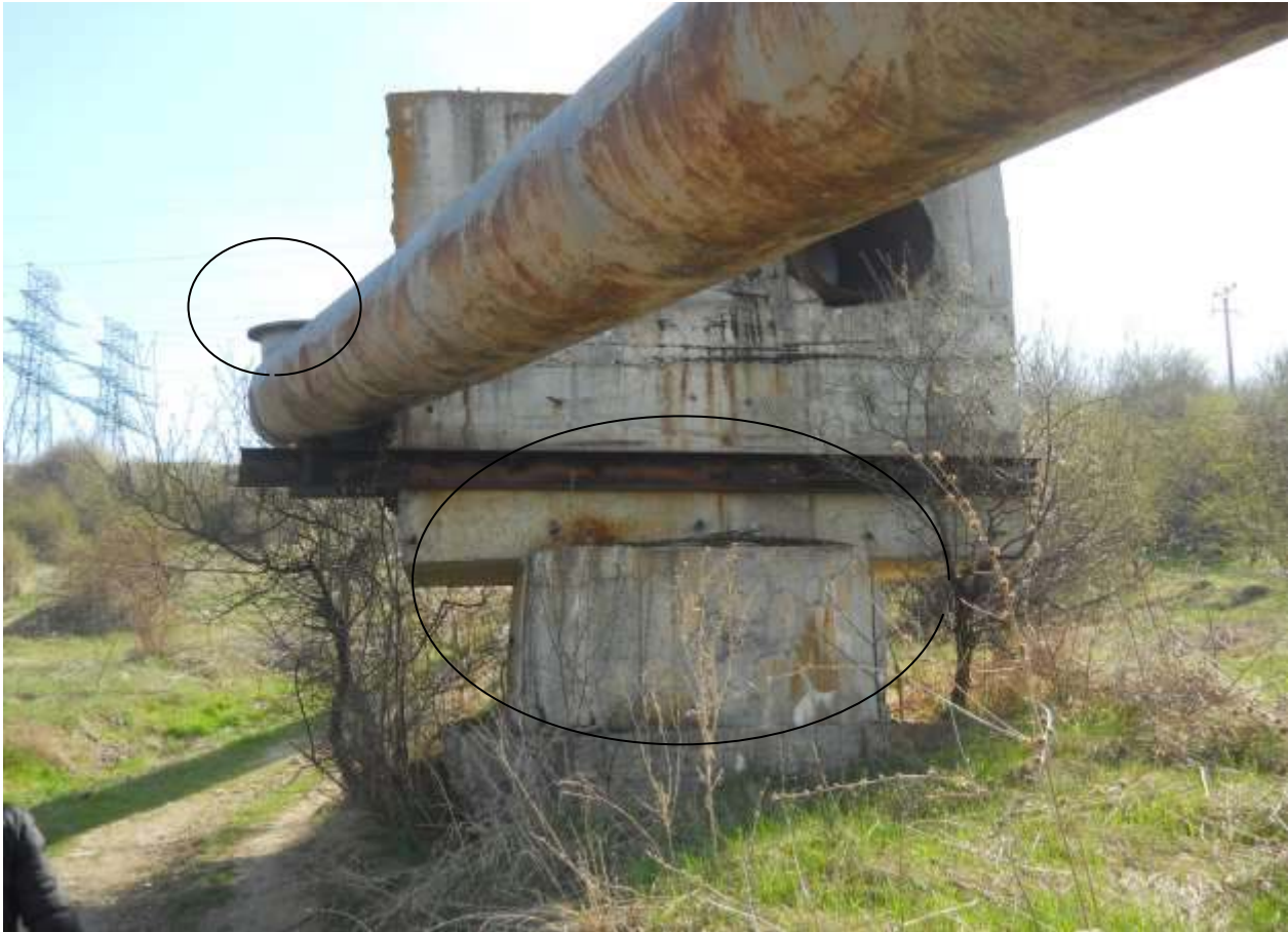
Detaliu tronson C2 – accesibilitate dificila, lipsa protectie gura de vizitare, stare avansata de degradare pilon sustinere, lipsa protectie exteriora conducta
