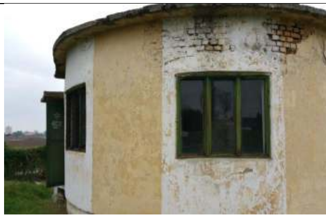
Cladire SPAU intrare Statie de Epurare
